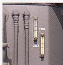
オイルゲージ(作動油タンク)
